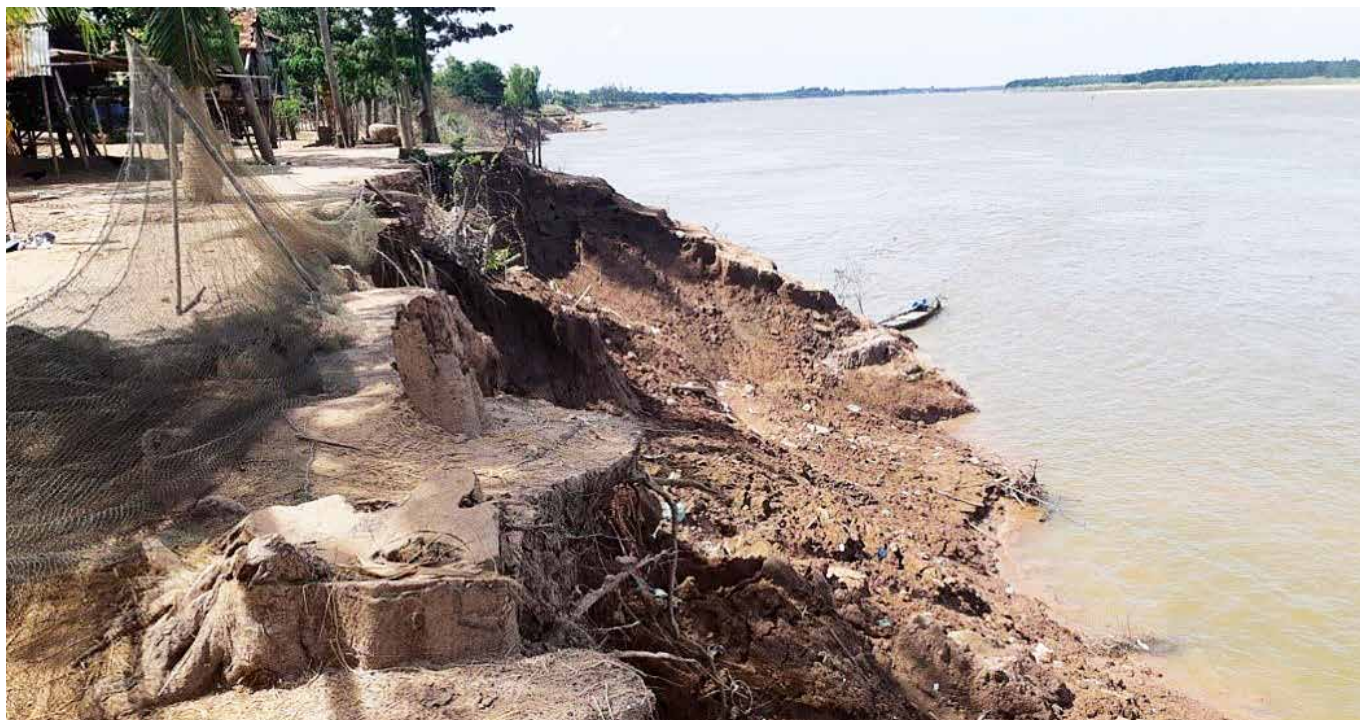
Erosion entlang des Mekong, Kambodscha (Foto: L. van Arragon, Oktober 2019).
